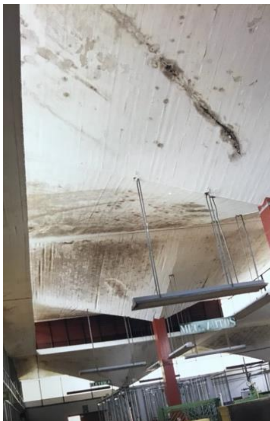
Figura 3. Imagem do acervo do SENAI, datada de 1999, mostrando a condição das lajes dos paraboloides devido ao acúmulo de umidade.
