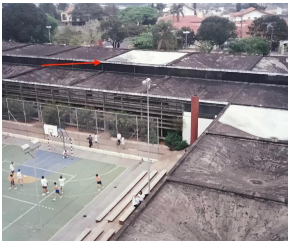
Figura 4. Imagem do acervo do SENAI, datada de 1999, mostrando a condição das lajes dos paraboloides devido ao acúmulo de humidade e sua borda, em destaque (seta indicativa), manchada com sujidades.
